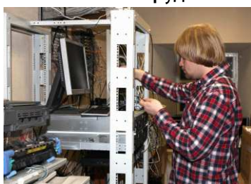
Установка IP АТС и телефонизация
